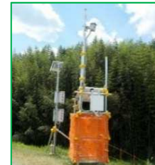
危機管理型水位計(国) 簡易型河川監視カメラ(国)
