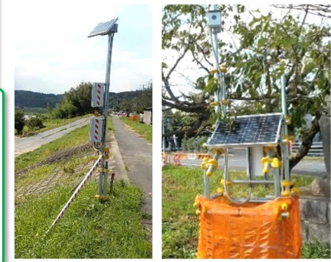
危機管理型水位計 簡易型河川監視カメラ
