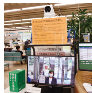
市民ホールに設置されたサーマルカメラ
