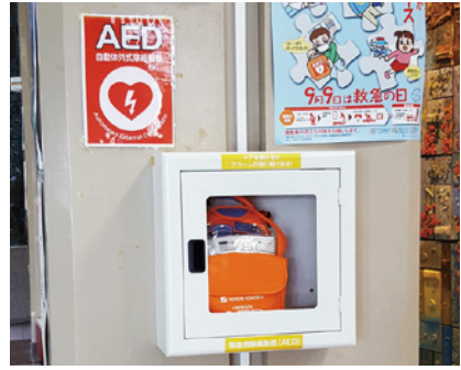
公共施設内に設置されているAED
